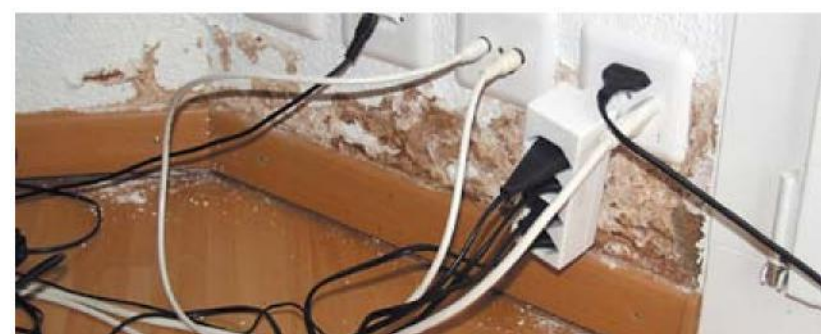
Gefährlich: Wassereintritt unterhalb einer Stromleiste. der einzelnen Berufsgattungen sind gross, um die Bauqualität laufend
