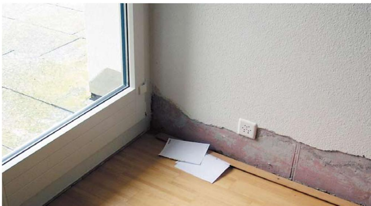
Offensichtlicher Baupfusch: Feuchteschaden an einer Wand in einer neu erstellten Terrassenwohnung.
