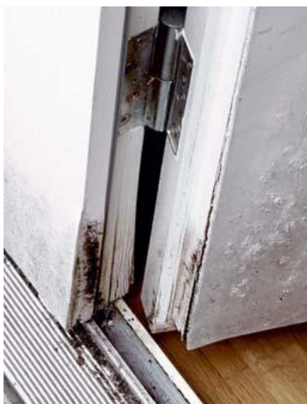
Pfusch: die vor Witterung ungeschützte Haustüre in einem kaum drei Jahre alten Haus.
