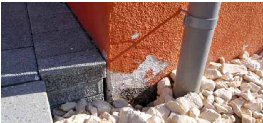
Verputzschaden wegen ungenügendem Feuchtigkeitsschutz.
