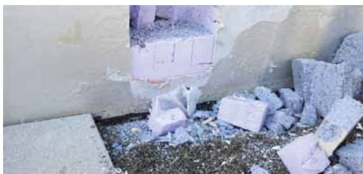
Feuchtigkeits- schäden an der Aussenwärme- dämmung.
