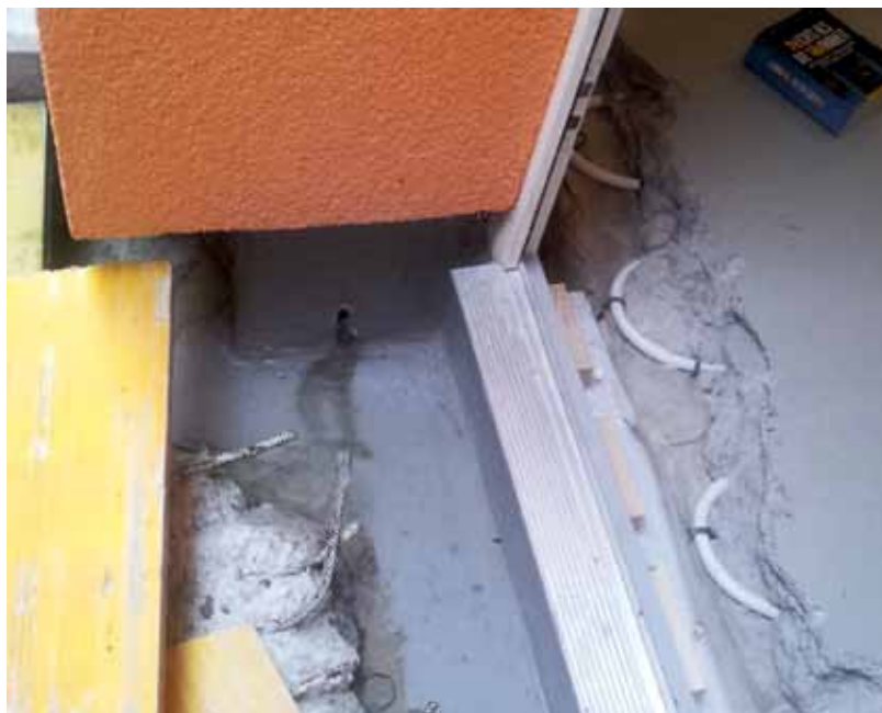
Wassereintritt: Kellertüren sind ungenügend abgedichtet.
